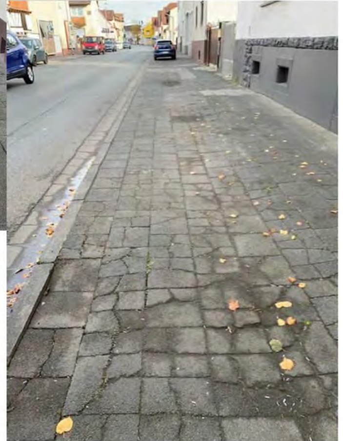
Gehwegschäden mit Absenkung
