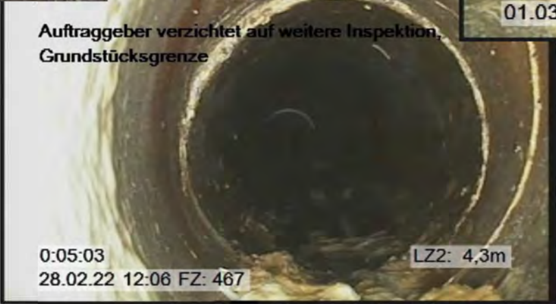
Kanal – Rissbildung, Abplatzung
